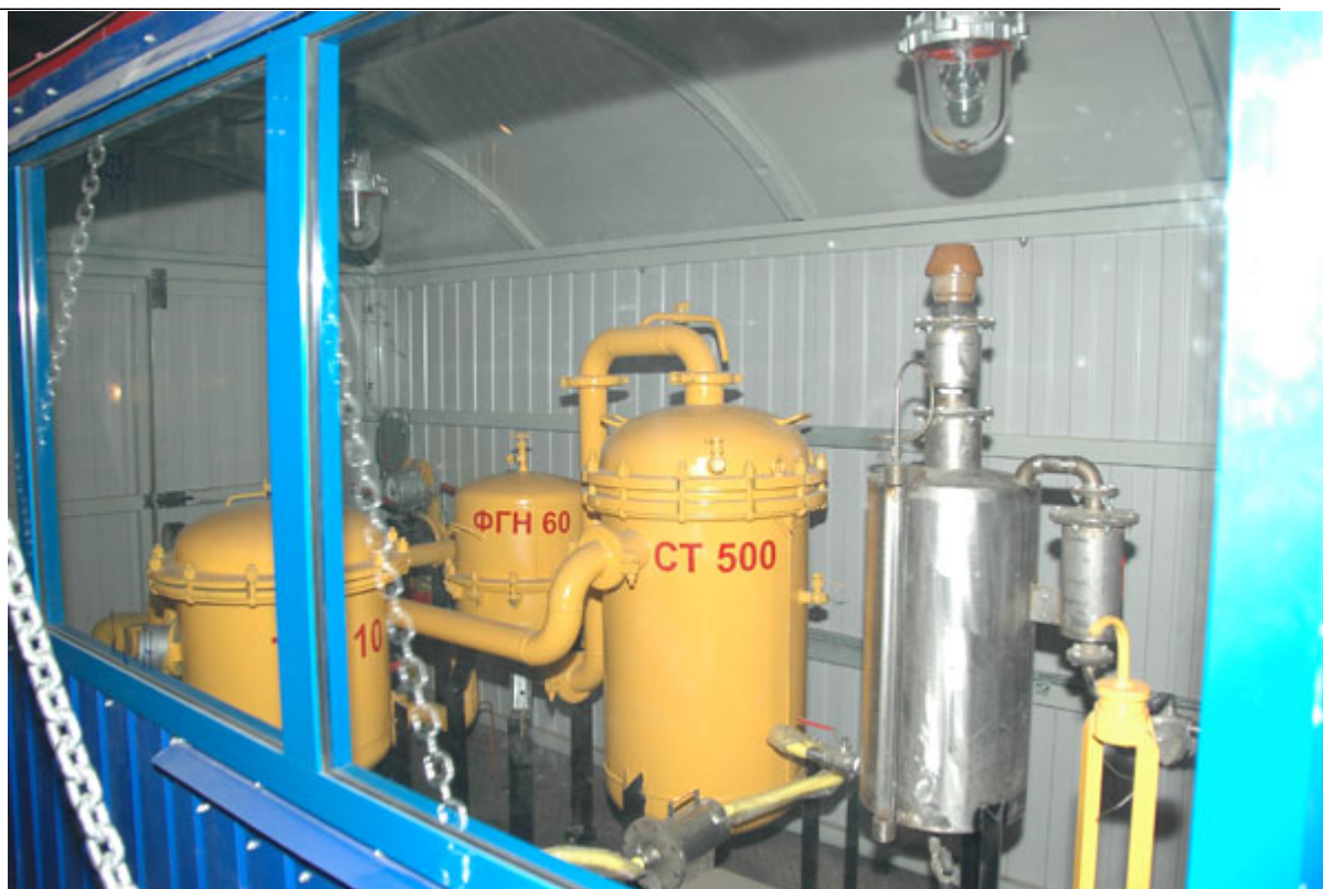
Рис.7. Пункт ПП-РП-30-У (снаружи).
