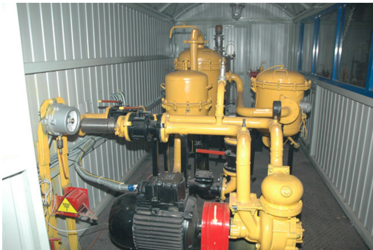
Рис.8. Пункт ПП-РП-30-У (изнутри).
