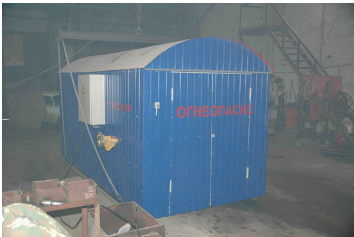
Рис.10. Пункт ПП-РП-30-У (снаружи).
