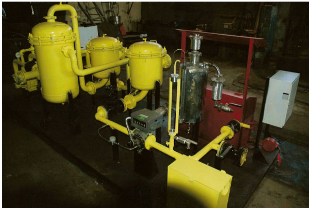
Рис.3. Пункт ПП-РП-30 (без укрытия).
