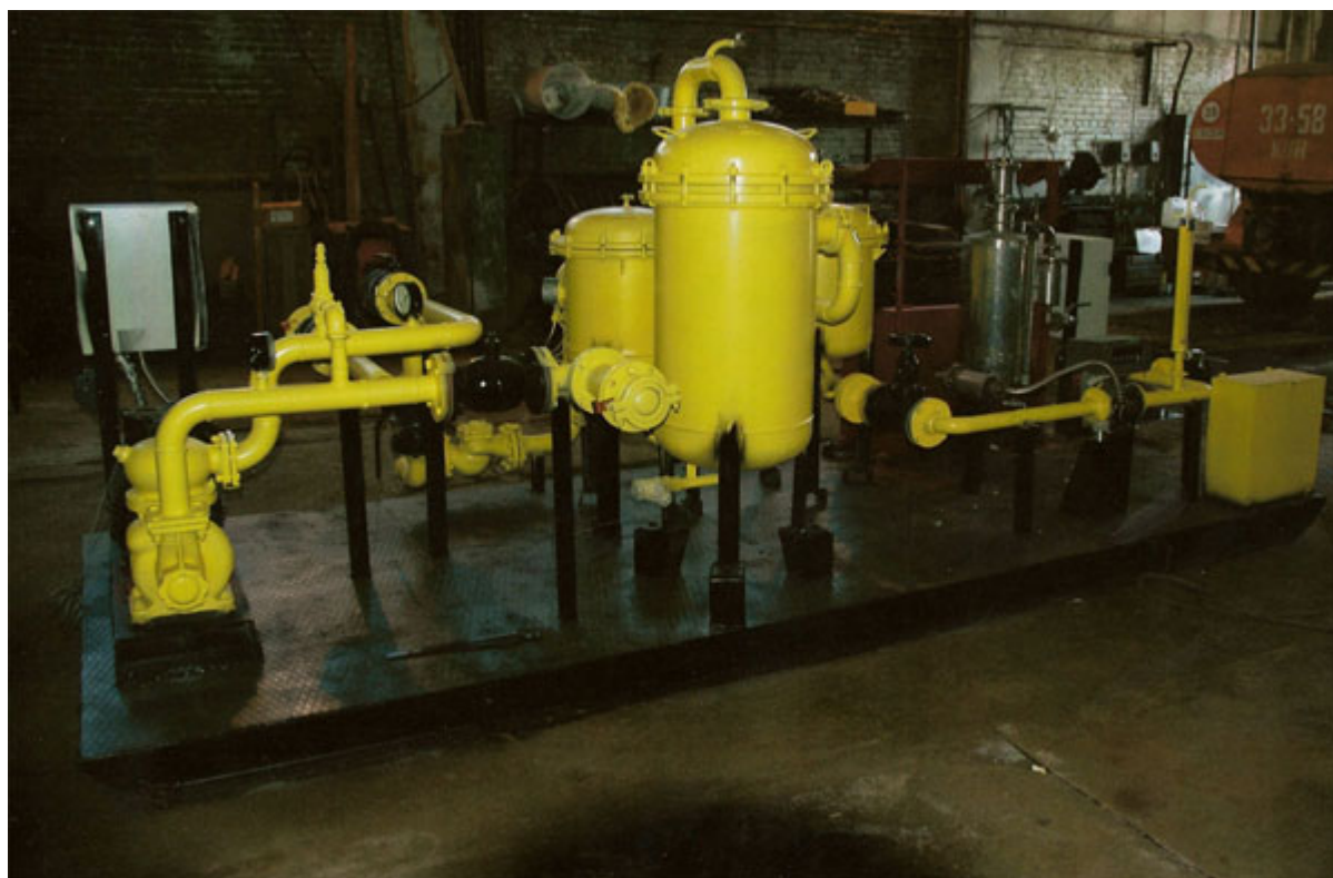
Рис.2. Пункт ПП-РП-30 (без укрытия).
